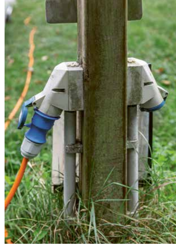
Stromanschluss auf einem Campingplatz (CEE-Anschluss)
